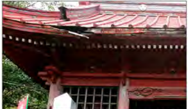
見積：内田幸夫様 仁王門の屋根 すくなくても補修が必要
