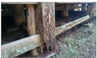
大日堂の縁側の柱 根元が腐り始めている
