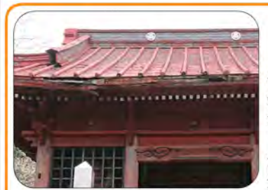
仁王門の屋根の軒先部分。傷みがひどく、早急に修復が必要
