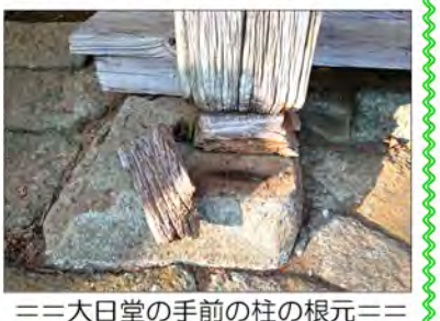
二二大日堂の手前の柱の根元二二 すぐにも補修が必要な状態です
